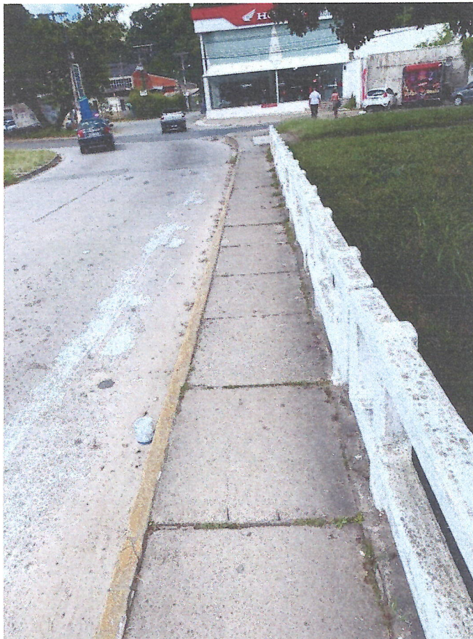
Figura 43 - Calçada irregular na ponte de acesso principal entre as Avenidas. Fonte: Master Ambiental, 2022
