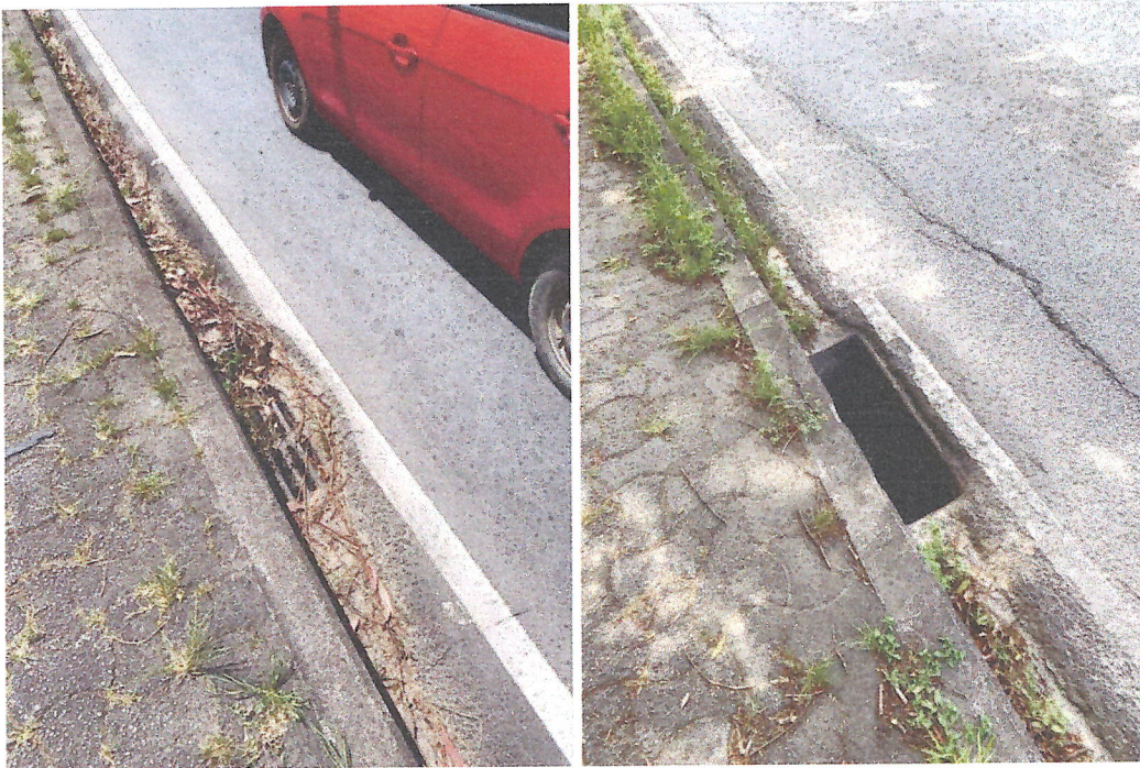
Figura 18 - Bueiros na Avenida Eng. Hans Gaiser. Fonte: Master Ambiental.
