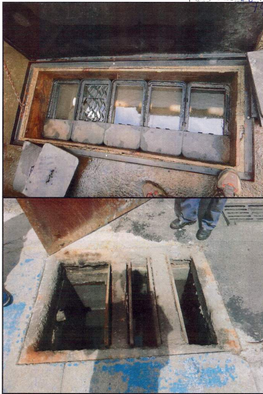
Figura 14: Caixas Separadoras de Água e Óleo (SAO) do efluente advindo da lavagem de carros (acima) e do efluente coletado nas canaletas da área das bombas de combustível (abaixo).
